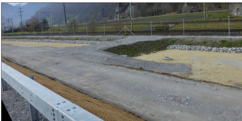
Neu erstellte SABA bei Trübbach mit einem Flächenbedarf von weit über 1 ha.
